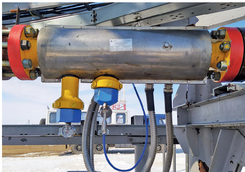
Рис. 2. Система коррозионного мониторинга в составе трубопровода обвязки газоконденсатной скважины № 2А142
